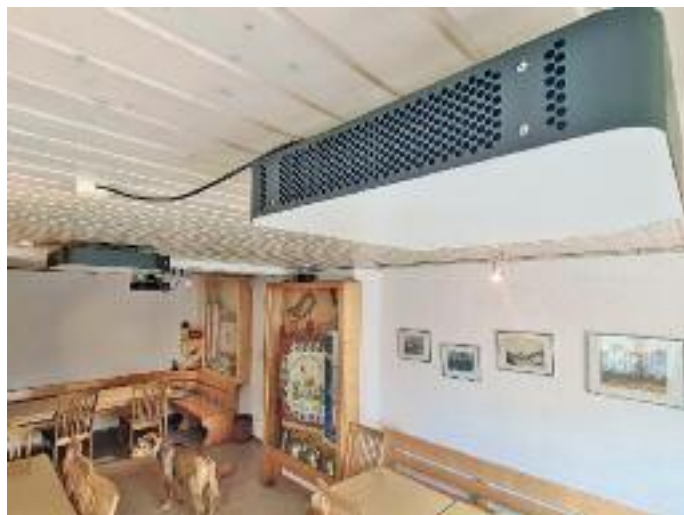
Die neuen Luftreiniger im Feuerwehrhaus
